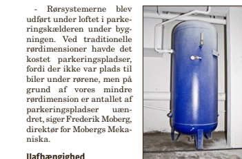
I A-huset får systemet sin blæsekraft fra ni lufttanke, der hver rummer 1000 liter.
