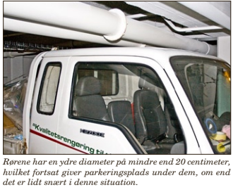
Fra komprimatoren blæses det videre i rørene, der i A-huset er ført op under loftet i parkeringskælderen.
